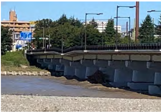
台風19号で橋脚が沈下した日野橋
